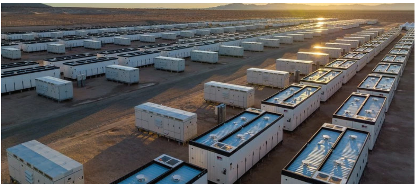
Vận hành toàn bộ công suất Waratah Super Battery có khả năng cung cấp điện cho khoảng 340.000 hộ gia đình tại thời điểm nhu cầu phụ tải cao nhất.
