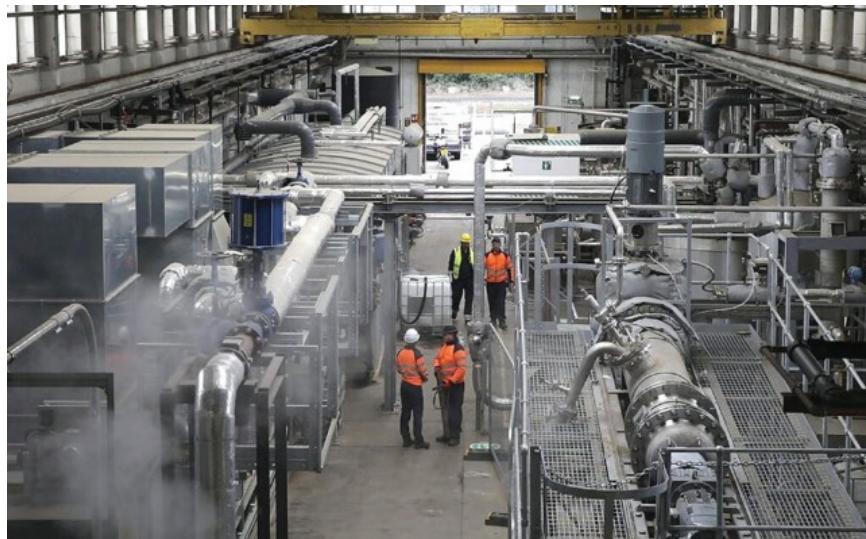
Nhà máy thử nghiệm công nghiệp đặt tại Teesside của Nova Pangaea Technologies
